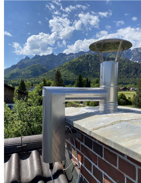
© Oekosolve; Staubfilter/-abscheider an der Schornsteinmündung
