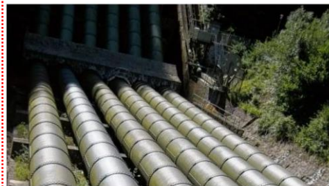
Wasserkraft in Bayern: Anlagen wie das Walchenseekraftwerk (im Bild die Rohrleitungen) erzeugen im Freistaat 1,3 Mrd. kWh Strom jährlich. Foto: Jens D. Billerbeck
