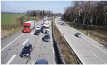
Maroder Fahrbahnzustand auf der A93, links von der Im-Bereich-Gelbthal Foto: Bund Naturschutz
